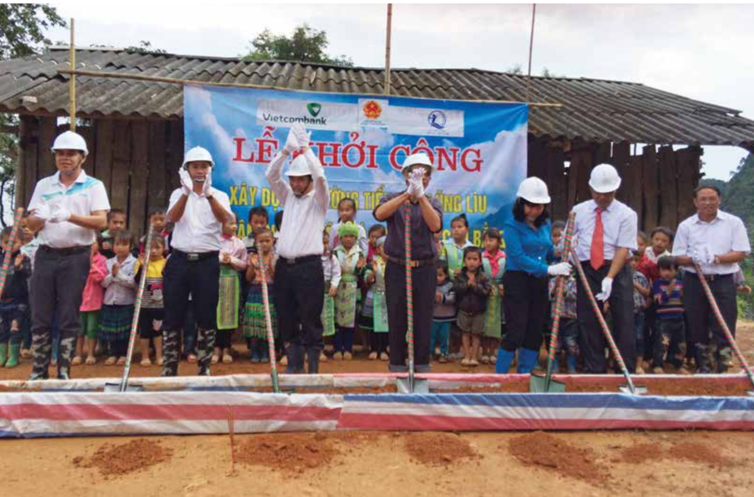
Lãnh đạo địa phương, Vietcombank và Quỹ Bảo trợ trẻ em Việt Nam tham gia lễ động thổ xây dựng Trường Tiểu học Lũng Lìu, xã Dân Chủ, huyện Hoà An, tỉnh Cao Bằng
